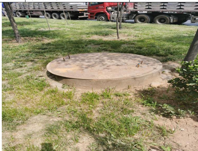
图 5-3 应急收集池照片
